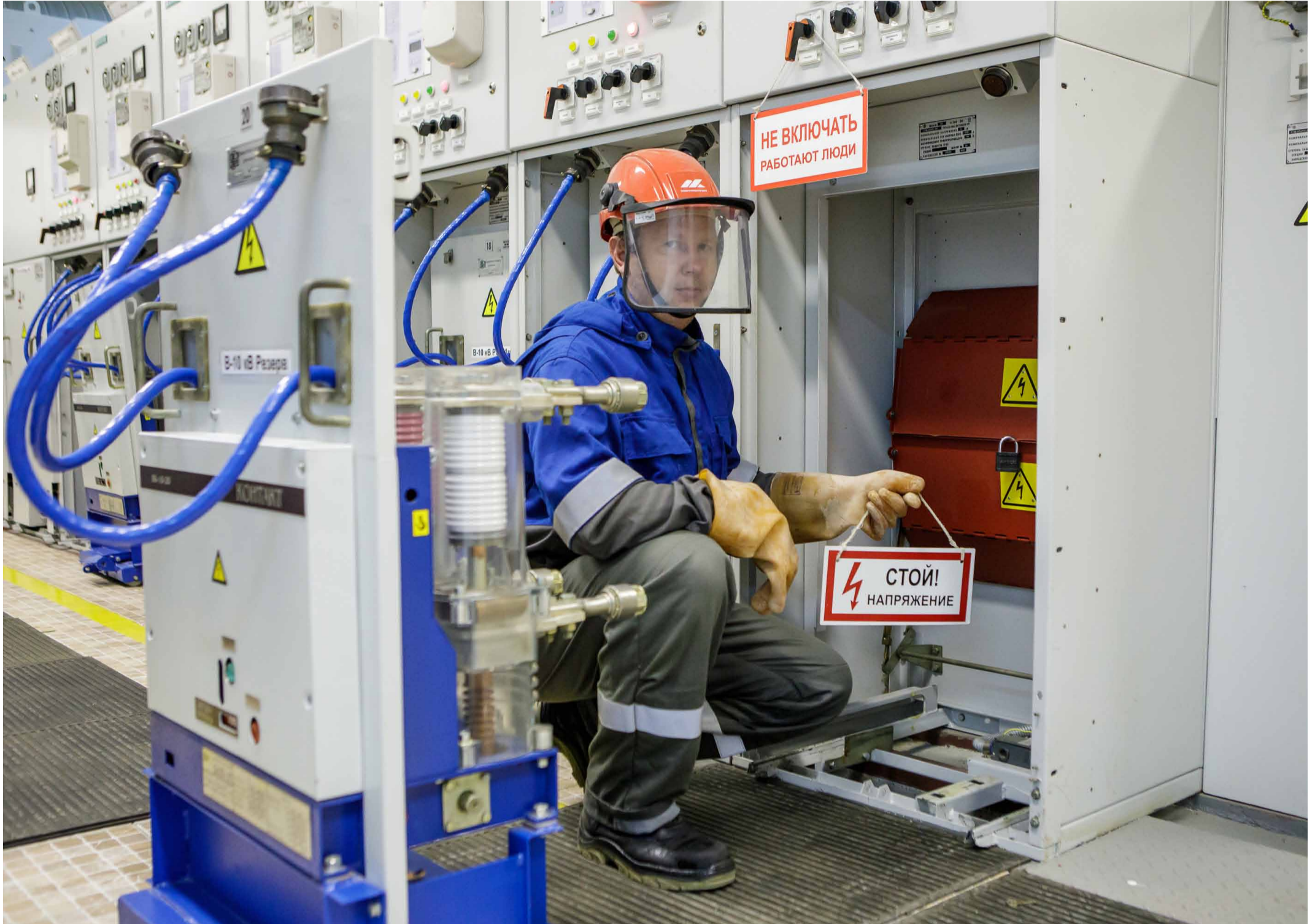
Электромонтер по ремонту и обслуживанию электрооборудования 6 разряда Петровского ЛПУМГ Алексей Кузьмин выполняет подготовку рабочего места для проведения ТО выключателя 10 кВ в ЗРУ-10 кВ на КС «Нововетровская»
