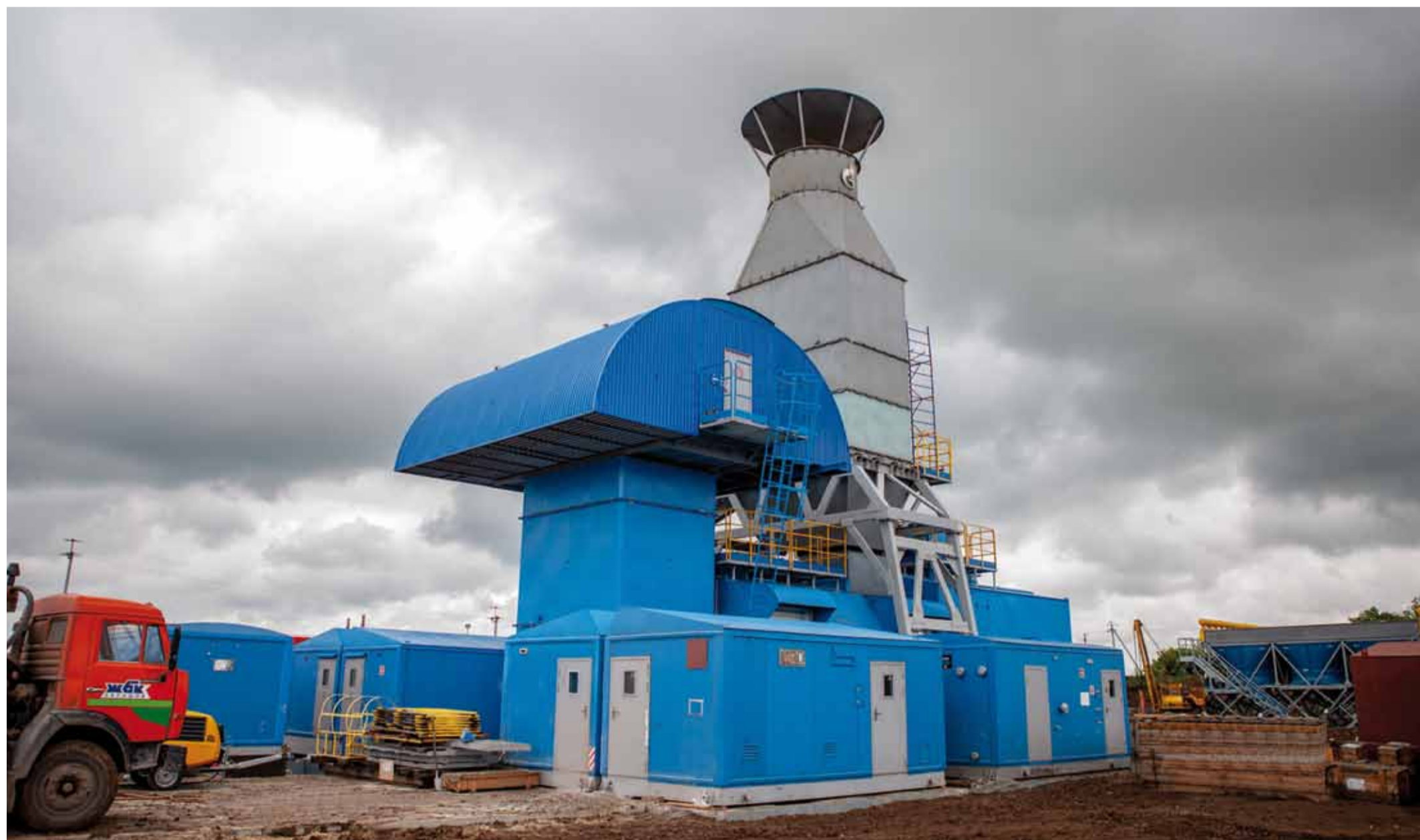
Газоперекачивающий агрегат №5 компрессорного цеха №2 Балашовского линейного производственного управления магистральных газопроводов.
