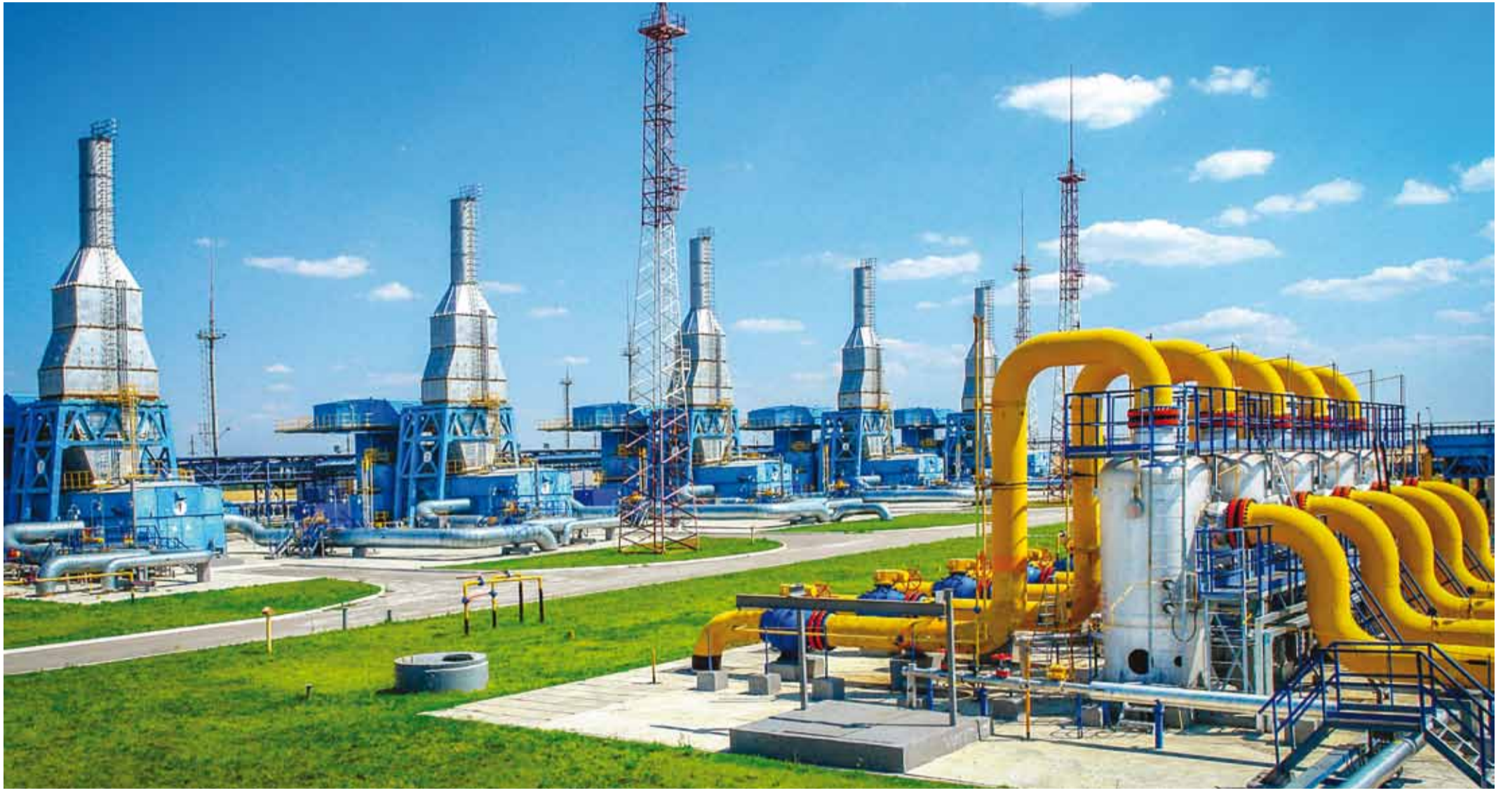
Компрессорная станция «Новопетровская»
