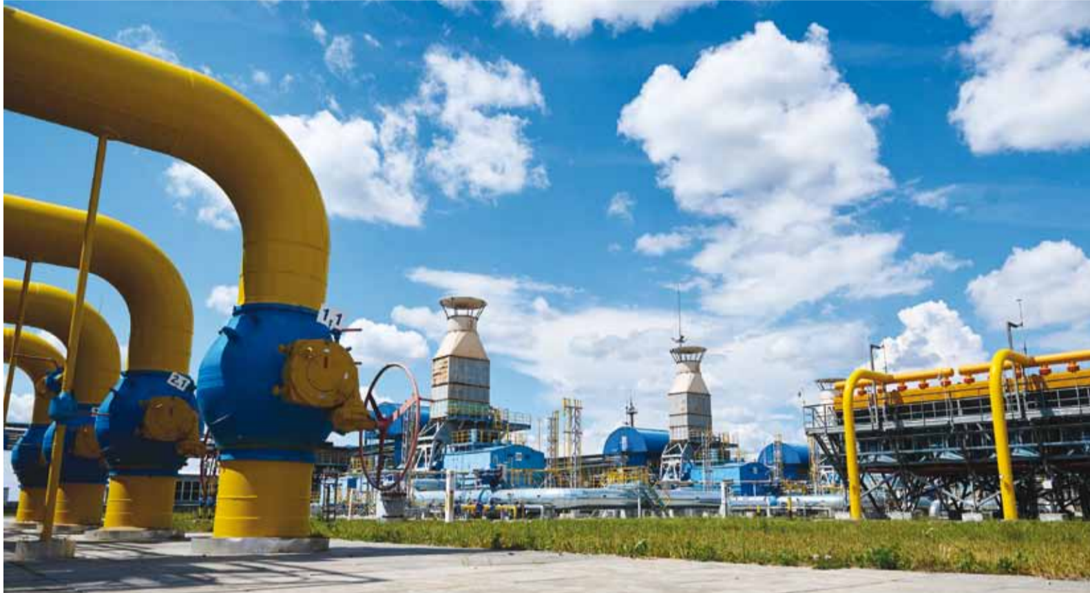
Компрессорный цех № 2 Балашовского ЛПУМГ
