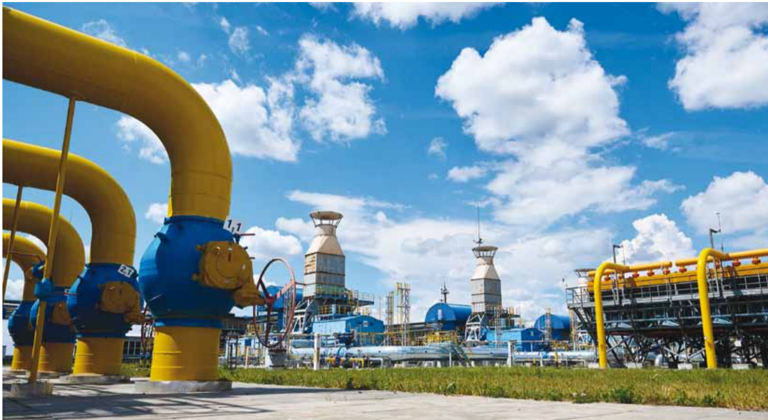
Компрессорный цех № 2 Балашовского ЛПУМГ
