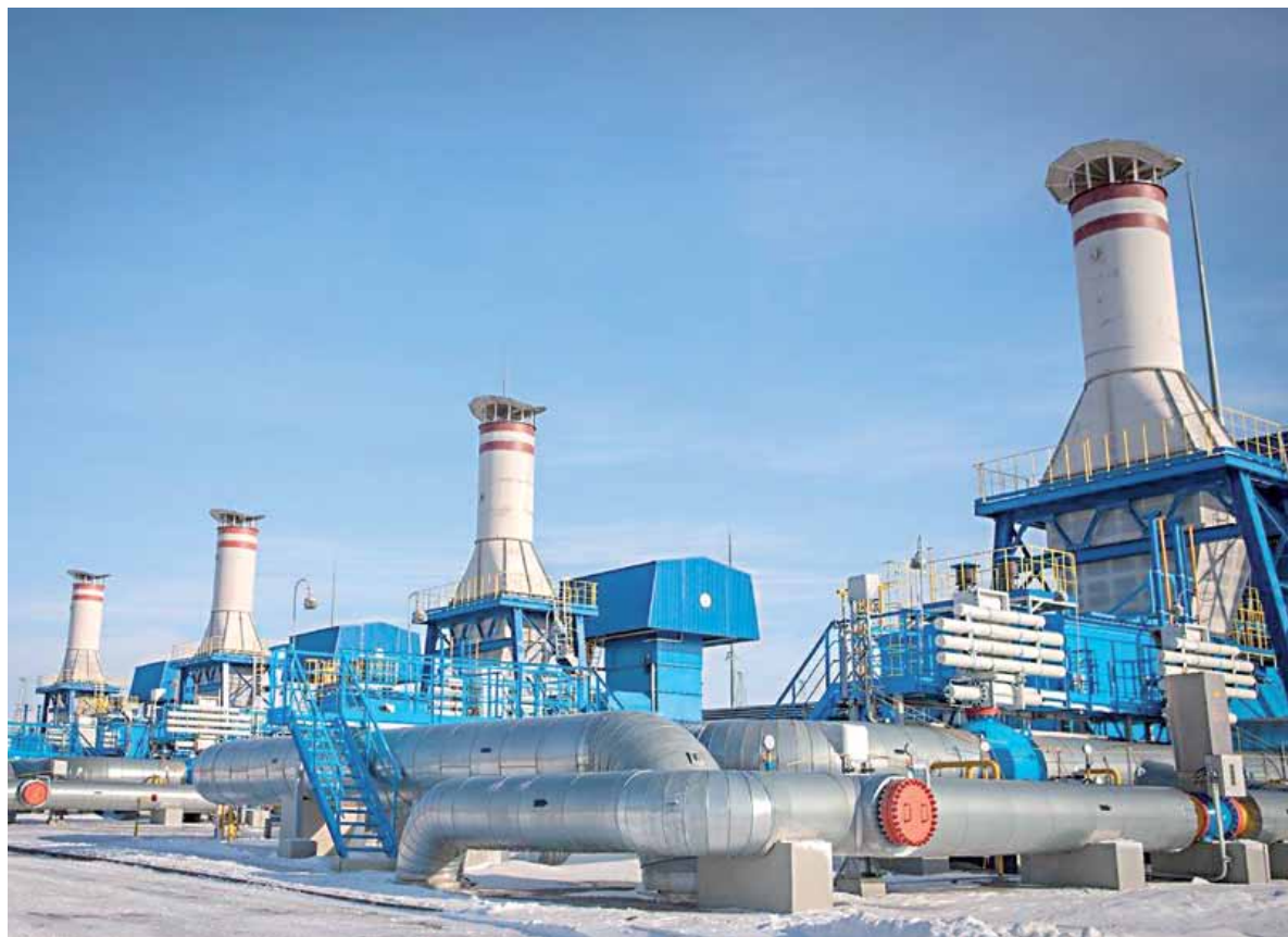
Общая протяженность эксплуатируемых предприятием газопроводов составляет более 7-ми тысяч километров.
