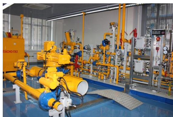
Газораспределительная станция, линейный крановый узел
