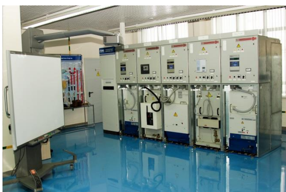
Электрооборудование компрессорных станций
