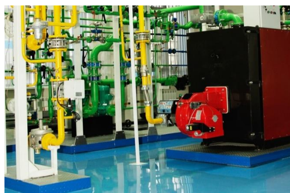
Котельная на газообразном топливе
