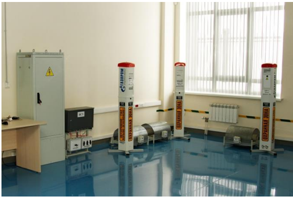
Установка катодной защиты
