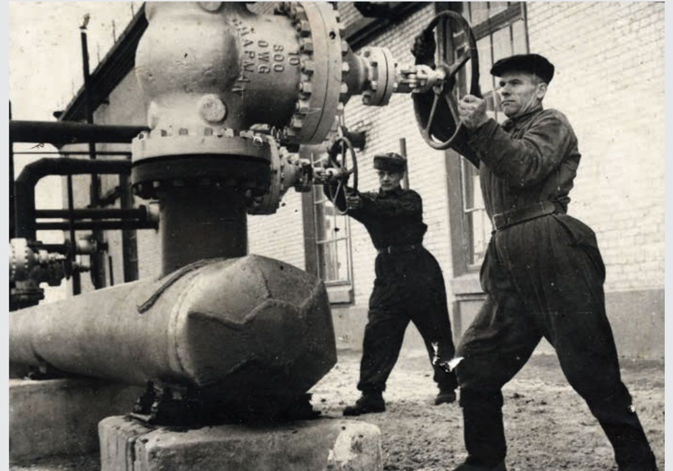
Кологривовская компрессорная станция. 1946 г.
