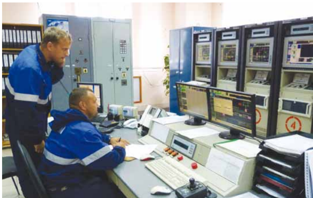
Главный щит управления цеха № 2-3 Сторожевского ЛПУМГ. Наши дни
