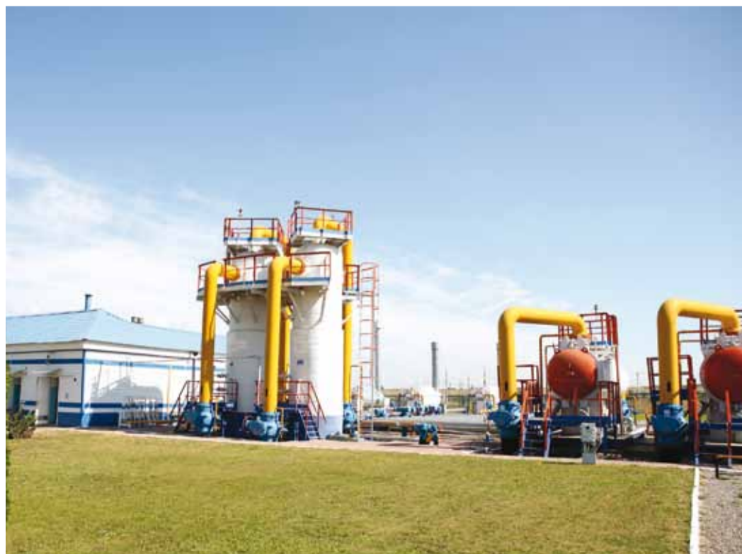
Мероприятия по повышению эффективности использования имеющихся технических возможностей подачи газа через газораспределительные станции проводятся на постоянной основе. ГРС-2, Сторожевское ЛПУМГ
