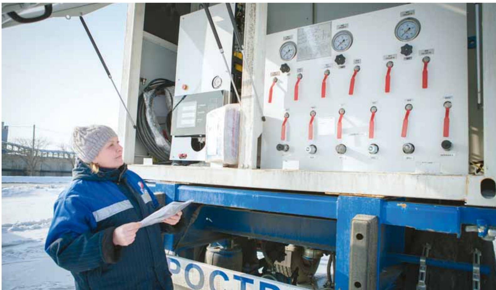
Кладовщик УМТСиК Ольга Филиппова осматривает заправочное оборудование ПАГЗа
