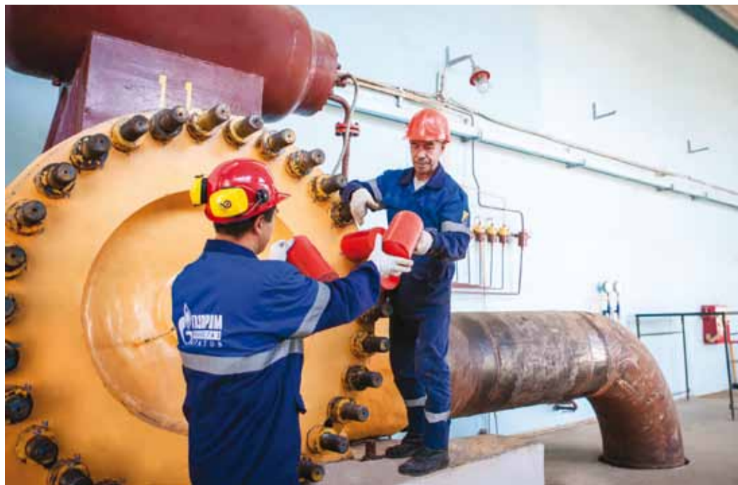
На компрессорной станции Александровогайского ЛПУМГ
